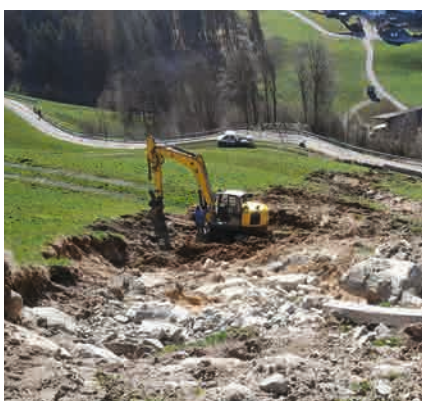
St. Jakob, Wasserleitungsbruch repariert
