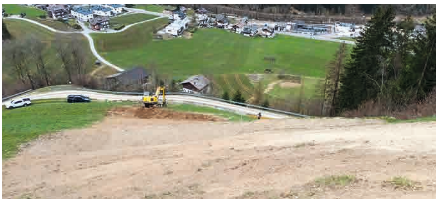
St. Jakob, Wasserleitungsbruch repariert
