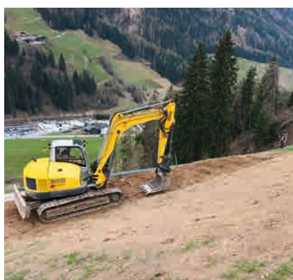
St. Jakob, Wasserleitungsbruch repariert
