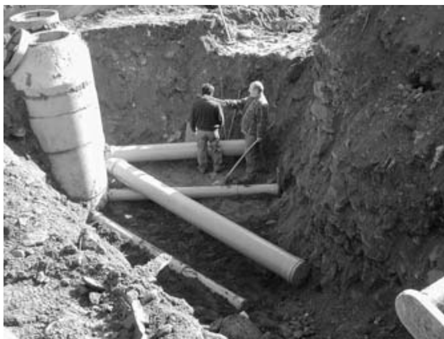
Das Bild zeigt die ordnungsgemäße Trennung von Abwasser und Regenwasser
