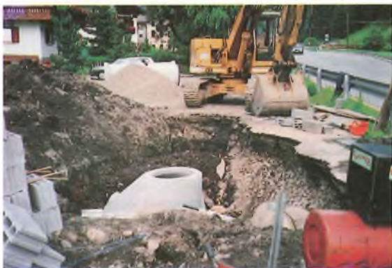
Die unterirdische Bautätigkeit in der Gemeinde Ahrntal hat heuer wohl noch nie dagewesene Ausmaße erreicht. Wasserleitungen, Kanalisierungen, Strom... Assessor Gottlieb Mairhofer hatte alle Hände voll zu tun. Unser Bild: Kanal Ost, Garber St. Jakob
